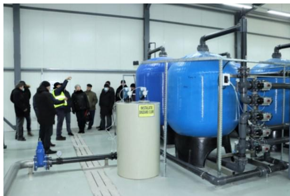
Modulul stației de tratare
